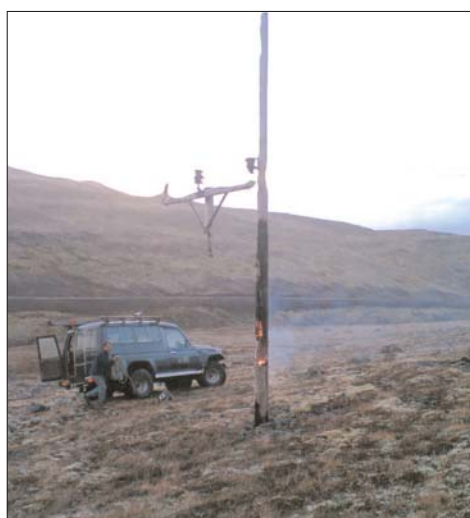
Staurabruni á 66 kV Patreksfjarðarlínu 1.
